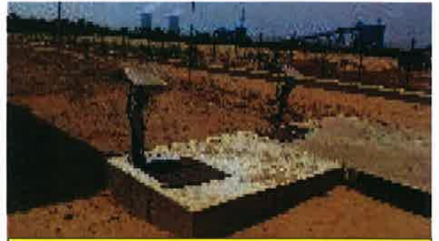
PT & CT Flow meter
