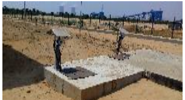
PT & CT Flow meter
