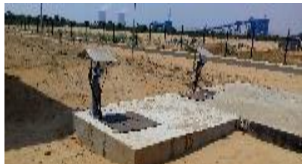
PT & CT Flow meter
